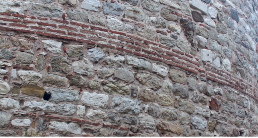
Şekil 12a-12b: Galata Kulesi'nin üçüncü katındaki tuğladan kuşağın farklılaştığı noktalar ve üzerindeki çatlaklar. Fotoğraf: Hasan Sercan Sağlam, 2020.
