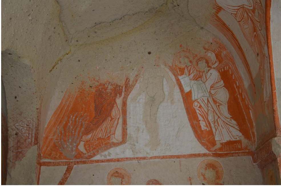
Şekil 5. Göreme Vadisi'nde Bulunan Saklı Kilise Taşıyıcı Kayada ve Duvar Resimlerinde Görülen Doğal Bozulmalar
