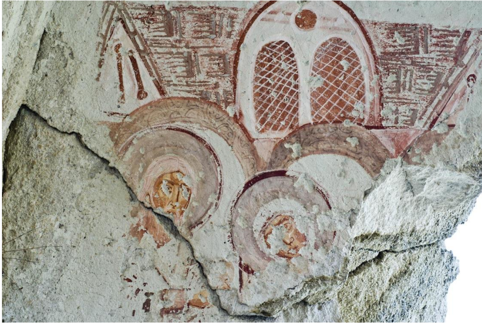
Şekil 6. Göreme Kılıçlar Vadisi'nde Bulunan Meryemana Kilisesi'nde Yapısal Çatlaklar
