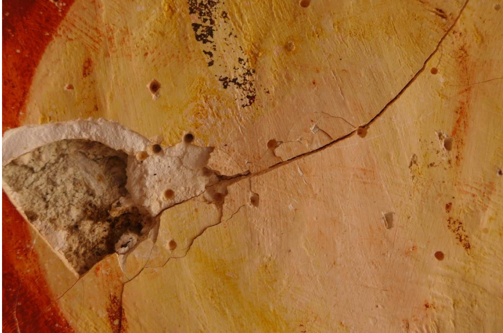
Şekil 8. Kızılçukur Vadisi Üzümlü Kilise'de Sıva Tabakasında Görülen Çatlaklar
