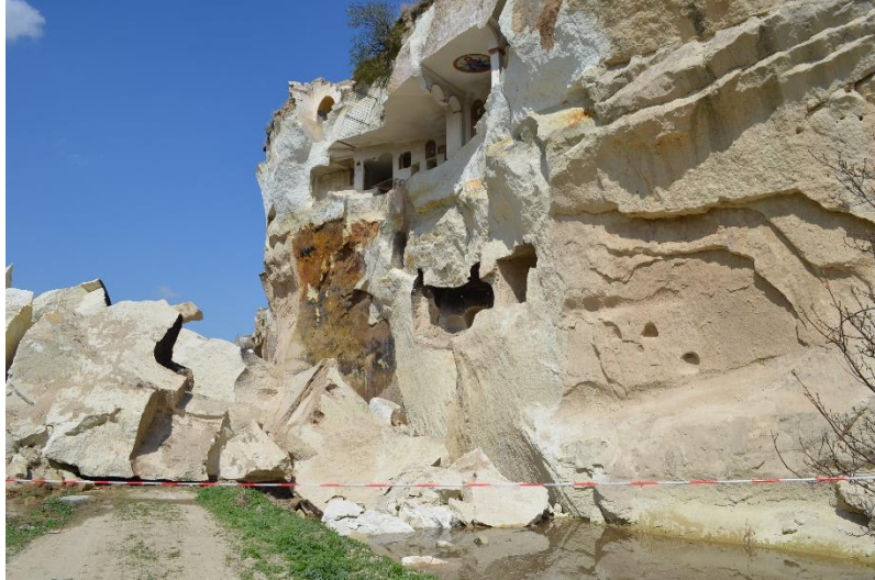
Şekil 4. 2017 Nisan ayında Doğal Nedenlerden Bir Kısmı Yıkılan Ürgüp-Mustafapaşa Kasabası'ndaki Aziz Vasilios Kilisesi
