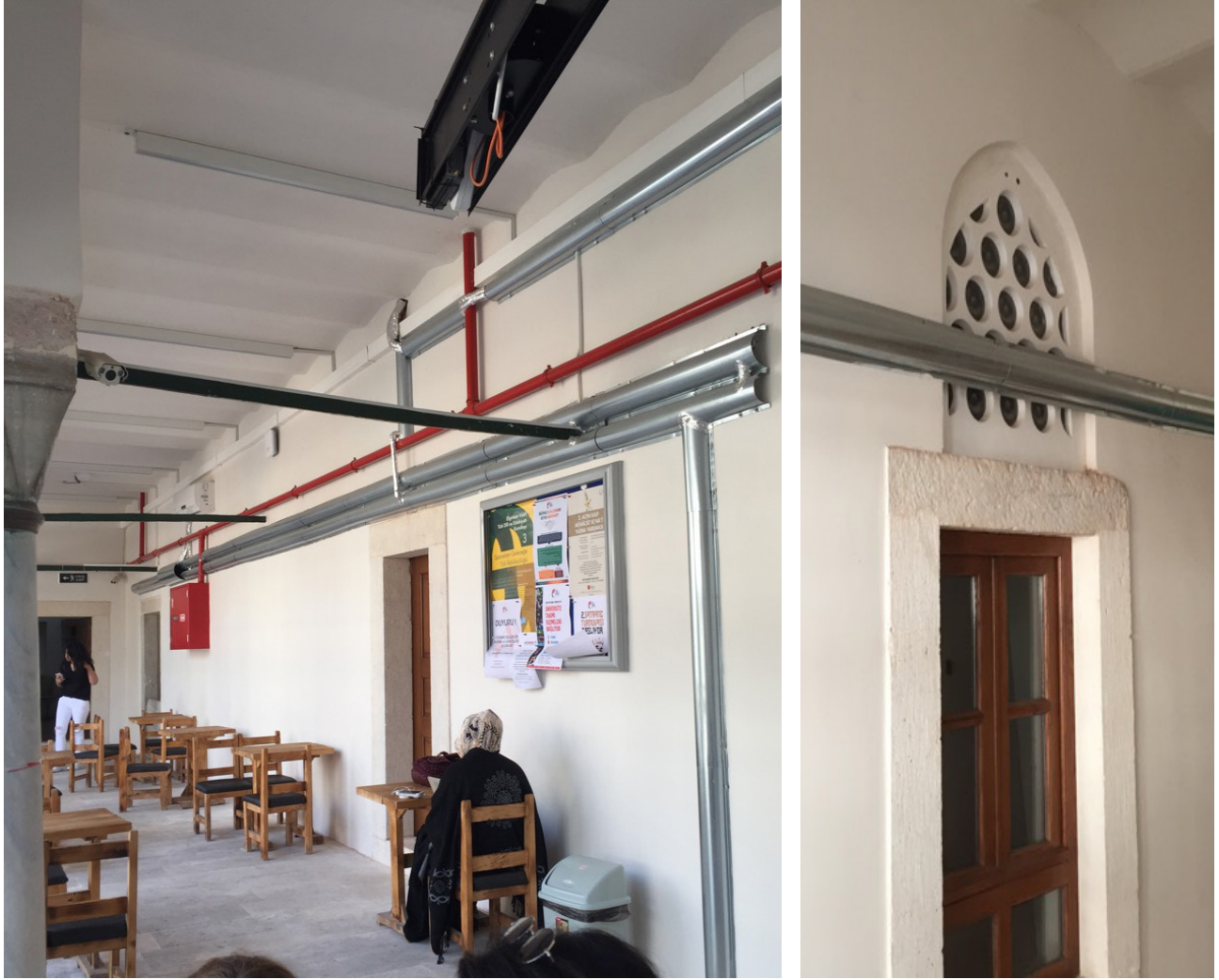
Şekil 4 Mimari bütünlüğe zarar veren teknik altyapı unsurları, Atik Valide Külliyesi, Dârüşşifâ
