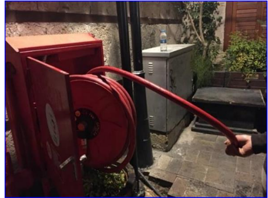
Şekil 9. Yangın hidrantlarının illegal kullanım örneği
