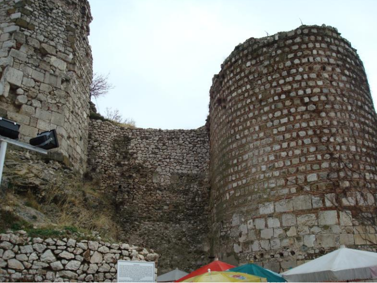
Foto.6- Eğirdir Kalesi. Moloztaş örgülü muhdes duvar.
