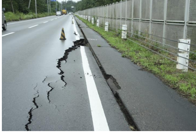
Şekil 11. İngiltere’de yapılan çatlama operasyonu sonucunda yolda oluşan hasar ( http://www.shalegas.international/2015/04/27/ )
