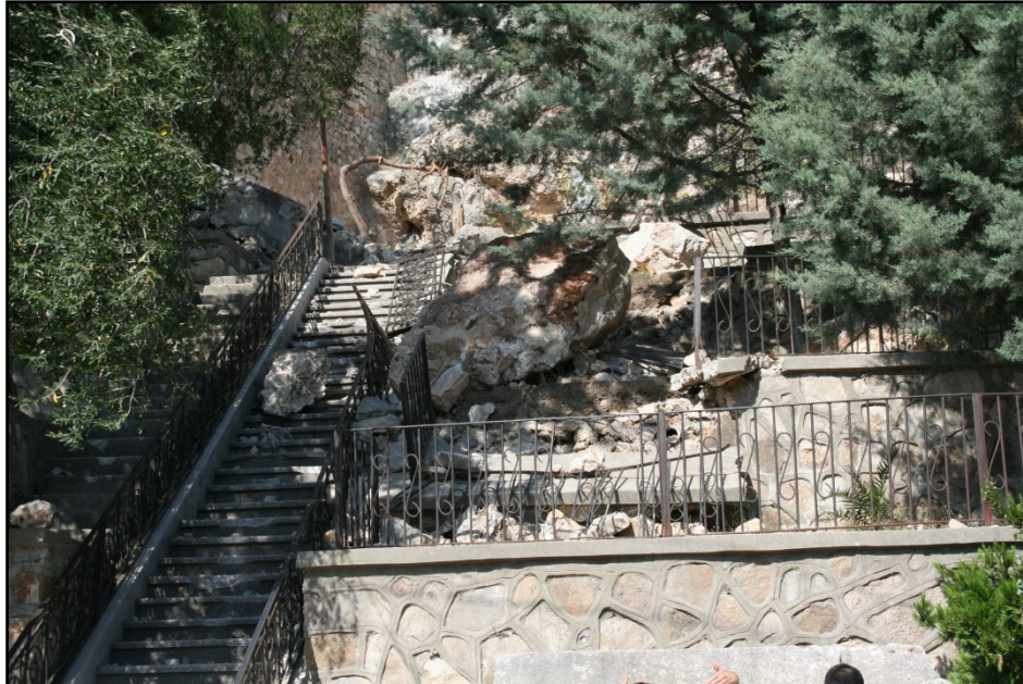
Şekil 3. Çalışma alanında meydana gelmiş kütle hareketi (2008 yılında meydana gelen kaya düşmesi) Figure 3. A mass movement that occurred in the study area (Rockfall occurred in 2008)
