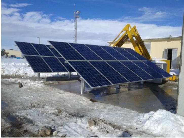
Şekil 5. Güneş enerji panelleri.
