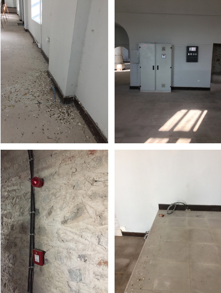
Görsel 9. Yapı içerisinde yer alan ısınma ve aydınlatma gibi teknik donanımlar
