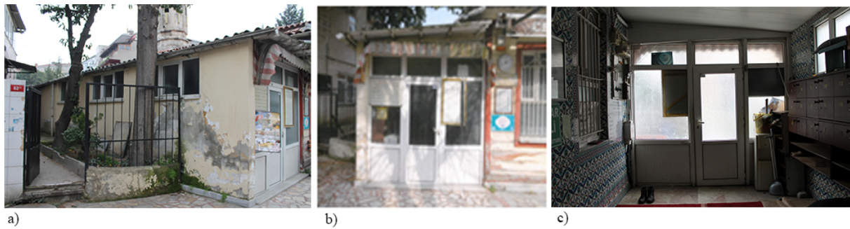
Şekil 10. Ek kısım; a) kuzey cephesi, b) batı cephesi, c) iç mekân, batı cephesi, 2018
