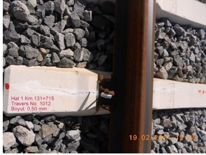
Şekil 12. Traverslerde görülen eğilme ve kesme çatlakları[21].
