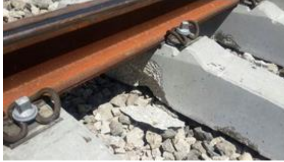
Şekil 7. Panel montajı ve oluşan hasarlar [21]
