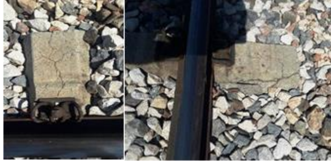
Şekil 1. Öngermeli Beton Traverste Gecikmiş Etrenjit Oluşumu[20]
