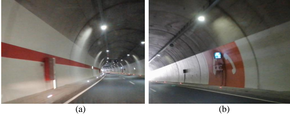
Şekil 17. (a) Yangın dolapları ve (b) acil telefon sehparının uygun olmayan şekilde yerleştirilmesi.
