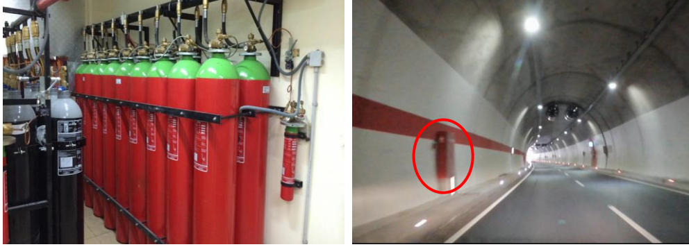
Şekil 7. Tünellerdeki otomatik yangın söndürme sistemleri [24].
