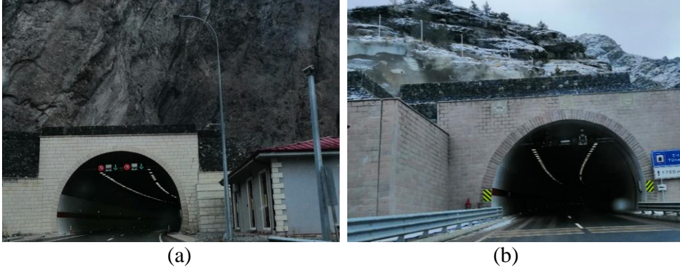
Şekil 15. Engebeye bağlı giriş ve çıkış portallarında yaşanan (a) kaya parçası düşme riski, (b) gerekli tüm tünellerde uygulanması gereken çözüm.
