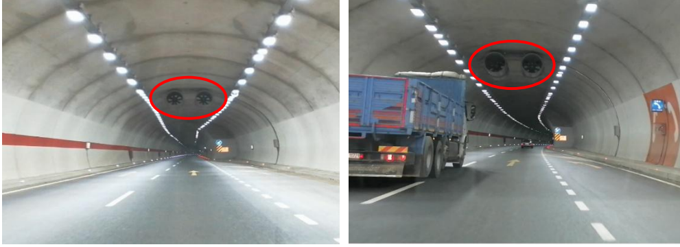
Şekil 4. Tünellerde yer alan tünel içi havalandırma sistemleri.
