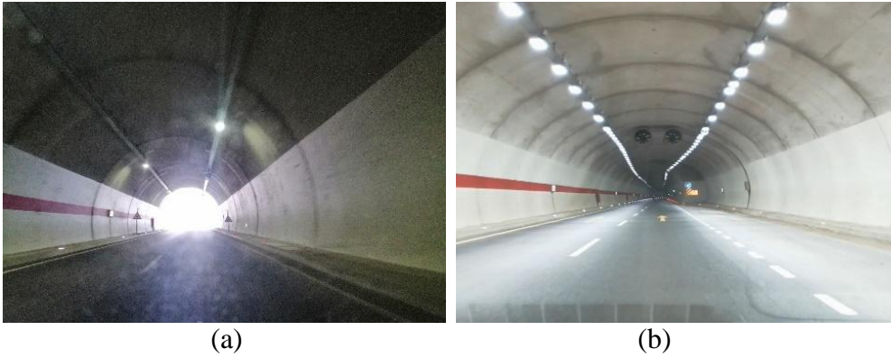
Şekil 16. Tünel giriş/çıkışlarında yaşanan (a) ışık farklılığı durumu, (b) otomatik aydınlatma sistemleri ile sorunun çözümü.
