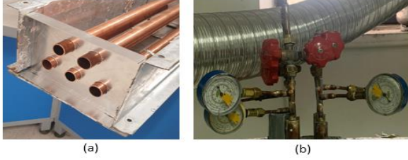
Şekil 4: a) Isı borularının yerleşimi b) Manometreler (a)Layout of heat pipes b) Manometers
