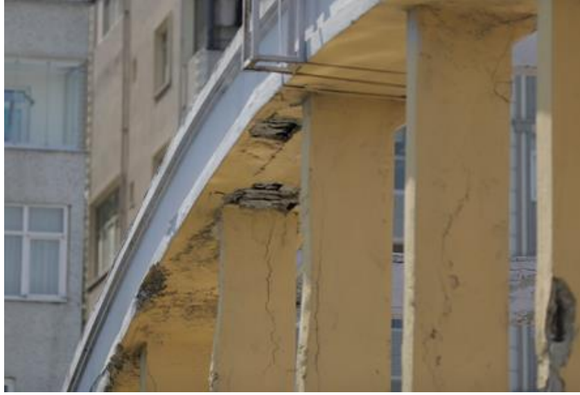
Şekil 15. Basınç kemeri bağlantı noktasındaki hasar, (Fotoğraf yazarlar tarafından çekilmiştir)
