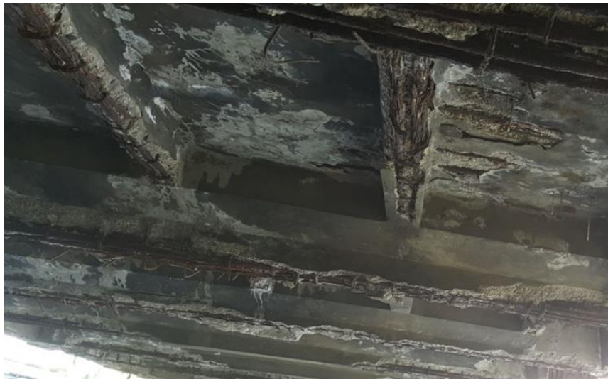
Şekil 17. Köprünün altbaşlığında oluşan aşınmalar ve donatılarda görülen korozyon (Fotoğraf yazarlar tarafından çekilmiştir)
