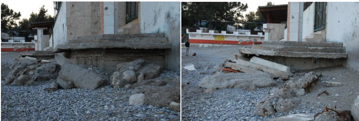
Şekil 8. Kıyı erozyonu nedeniyle oluşan zemin seviye farkı ve merdiven altındaki oyulma
