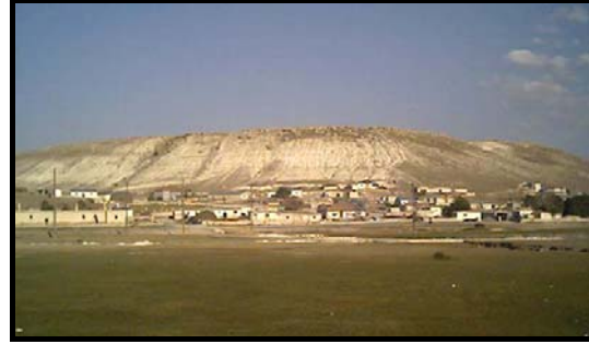
Fotoğraf 9. Örenşehir'de yerleşmeleri tehdit eden kaya düşmeleri (Photo 9. Rock falling which threat settlement of Örenşehir)
