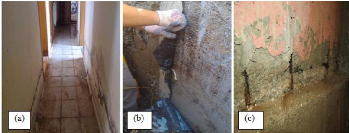
Şekil 1. Su yalıtımı probleminden dolayı zarar gören yapının bölümleri (a: sıva kabarmaları; b: yapıştırma yalıtım levhasının yüzeyden ayrılması; c: betonarme demirinin korozyona uğraması)
