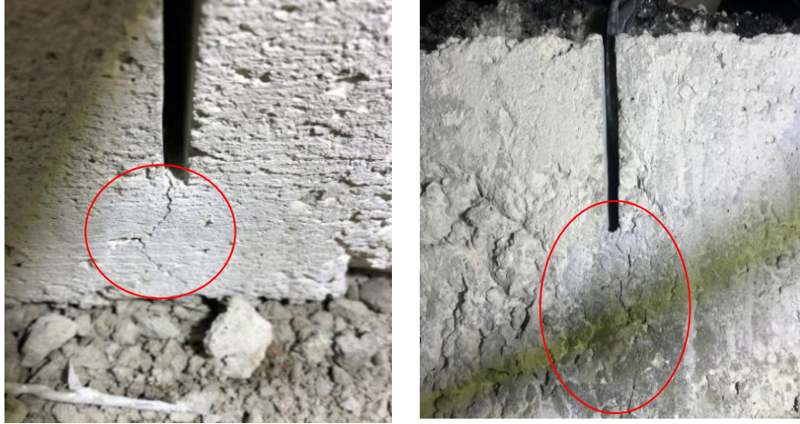
Şekil 12. HYT tesisinde görülen derz ilerleme çatlakları
