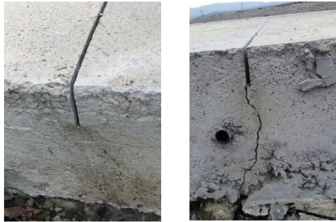
Şekil 11. Yarım derzlerde görülen derz ilerleme çatlağı
