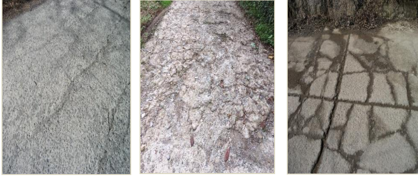
Şekil 8. Trabzon Ortahisar Kavala, Çilekli ve Dolaylı Mahalleleri'nde sökülme ve çatlaklar
