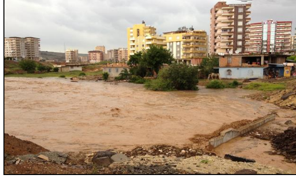
Resim 5. Karaköprü Deresi üzerindeki menfezlerden birisinin çıkışında akışı engelleyen malzemeler yüzünden oluşan birikme [5] (Photo 5. Because of the materials which obstruct flow, the build up occur on outlet of the culvert on Karaköprü River [5])
