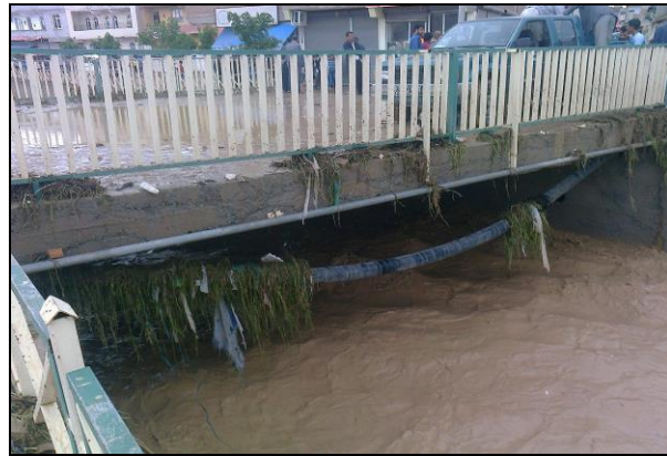
Resim 6. Telekomünikasyon hattı nedeniyle oluşan birikme ve kesit daralması ile akışın engellenmesi-Sırrın Deresi [5] (Photo 6. Because of the build-up which occur with telecommunication line and cross-section narrowing, the flow is obstruct-Sırrın River[5])
