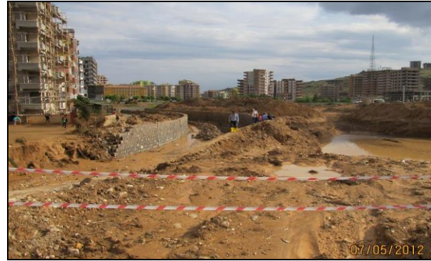
Resim 3. Yapım esnasında taşkından zarar gören Karaköprü Deresi taşkın duvarları ve taşkın duvarına sıfır, düşük kotta yapılaşma [5]. (Photo 3. The flood wall of Karaköprü stream was damaged by flood and building on low level [5])
