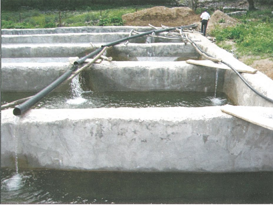
Şekil 1. Çatak-Elmacı 1 tesisi, havuzlara hatalı su girişi
