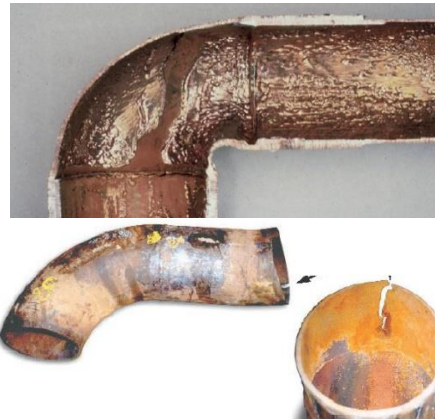
Şekil 1. Erozyon korozyonunun boru iç yüzeyinde görünümü (MEGEP 2012)
