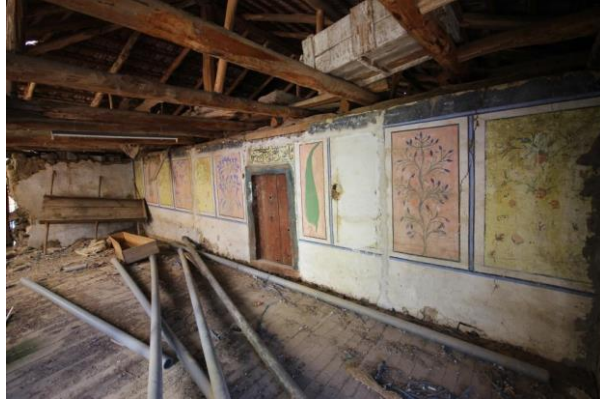
Resim-20: Kışlak Eski Camii Kadınlar Mahfili Güney Duvarı.
