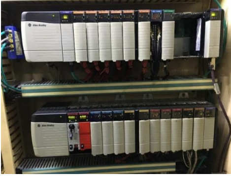
(b) PLC dönüşümü yapılmış kumanda sistemi
