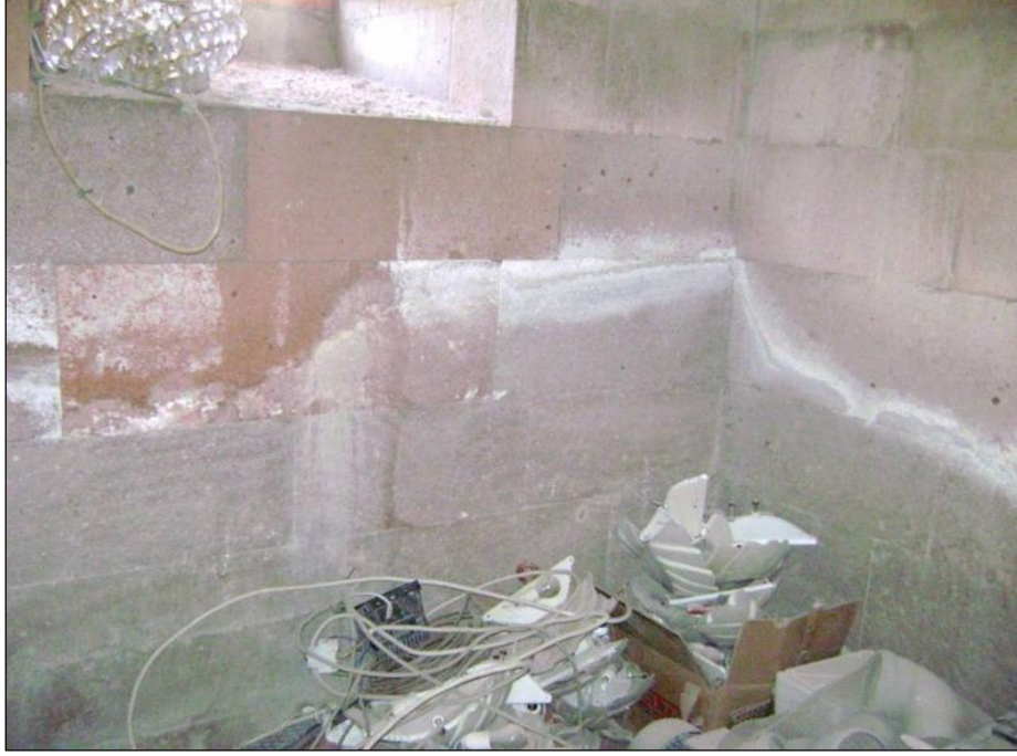
Şekil 11. Ak Medresenin iç kısmında ignimbiritlerde nemlenme nedeni ile meydana gelen çiçeklenmeler
