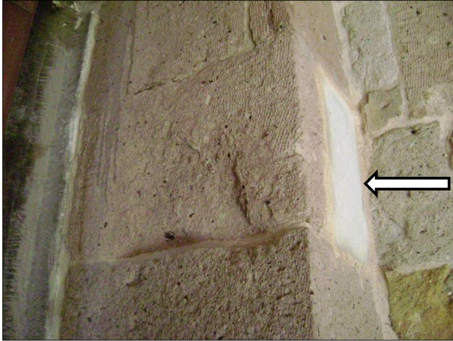
Şekil 12. Ak Medresede taş yüzeyinde yer yer 5 cm'yi aşan kopmalar ve yerine eklenen taş
