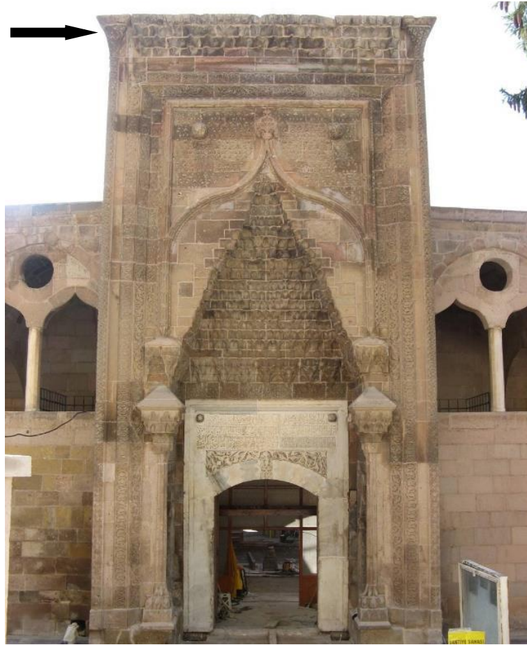
Şekil 16. Taç kapı üst kesiminde yağmur ve kar sularının drenaj sisteminin çalışmaması nedeniyle süslemelerde meydana gelen ileri derecedeki bozunmalar
