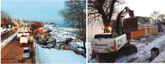
Şekil 9. Edremit sahil bandında kaçak yapılarla yapılan operasyon görüntüsü. Figure 9. A view of the municipality's demolishing illegal facilities nearby the coastal area
