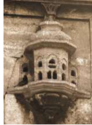
Görsel 4. Kuşevi, Yapının adı: Ayazma Camii, Binanın yapım tarihi: 18. yüzyıl (1760-61), Yeri: Üsküdar, İstanbul (Aycı, 2009:241).
