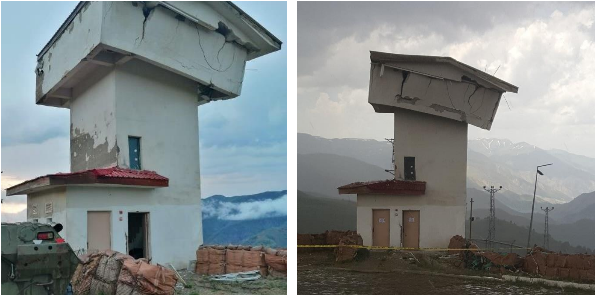
Şekil 11. Betonarme gözetleme kulesinde meydana gelen hasar
