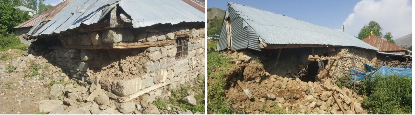
Şekil 6. Kot farklı sebebiyle kısa duvar oluşmasına bağlı hasarlar
