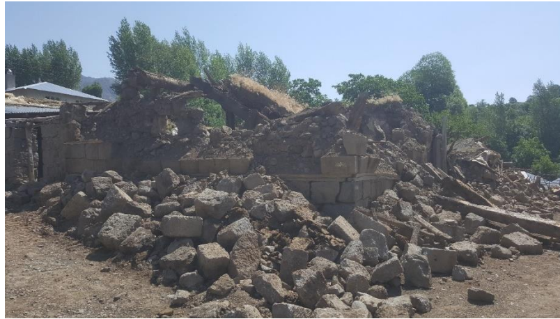
Şekil 9. Tamamen yıkılmış yığma binalar
