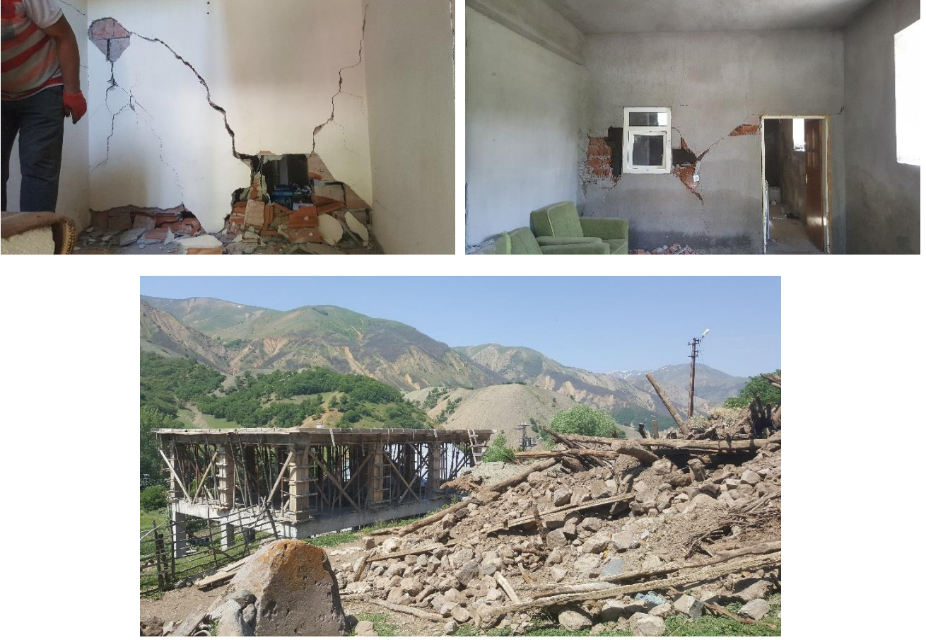
Şekil 10. Betonarme binalarda hasarlar
