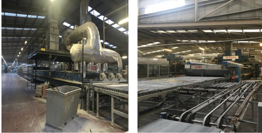
Şekil 6. Pişirimlerin gerçekleştiği Seranit firmasındaki Sacmi fırın (Sacmi furnace in Seranit company where firing takes place)
