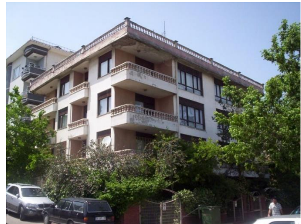
Şekil 7. Su ve ısı etkenlerinin oluşturduğu hasarlar nedeniyle yıpranmış betonarme bir yapı (Güzelçoban, 2007)
