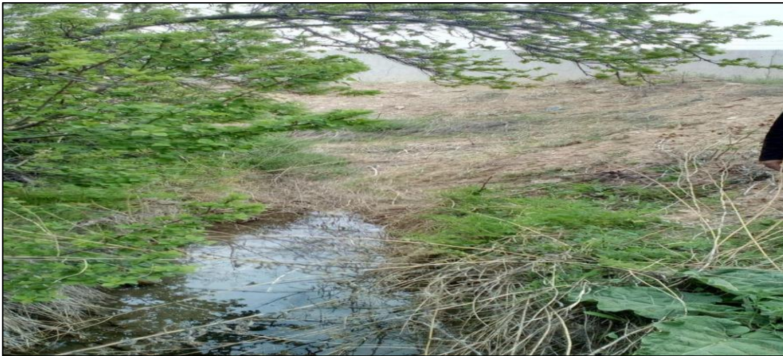
Şekil 10. Drenaj borularının ve filtre malzemelerinin yeterince çalışmaması nedeniyle İletim kanalının sol sahilindeki su birikmesi (Water accumulation on the left bank of the transmission channel due to the fact that the drain pipes and filter materials are not working properly).
