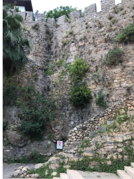
Şekil 25. Kırkmerdivenin Duvarının ve Kale Surlarının bitki ile kaplanmış hali (Açıkel, 2020)
