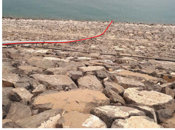
Şekil 3. Memba şevinin bozulmuş yüzey şekline ait bir görünüm
