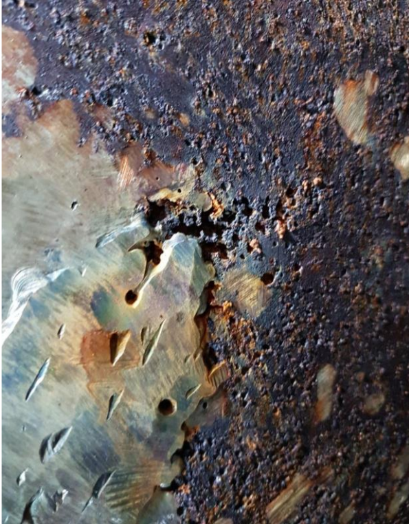
Şekil 5. Kanat yüzeyindeki kavitasyon gözenekleri ve hasarın görünüşü
