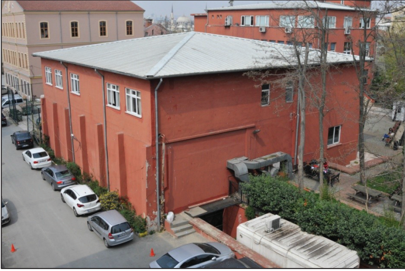
Eski Siklotron Binası'nın (bugün, SBMYO B Binası'nın bir kısmı) Eczacılık Fakültesi B Blok'un üst katından (Farmasötik Teknoloji ABD) görünümü; pencere kat sonradan eklenmiştir. (Fotoğraf: Kaan Ata, 02.04.2014)
