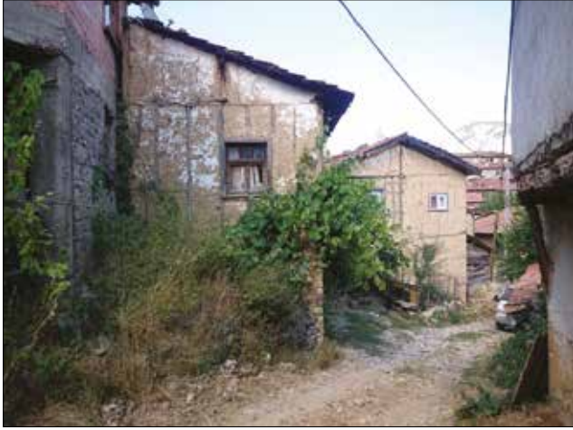
Fotoğraf 50. Yarıyı yıkılmış durumda yapı (E-98) (Yıldız, 2017) / Half-demolished (vertically) structure
