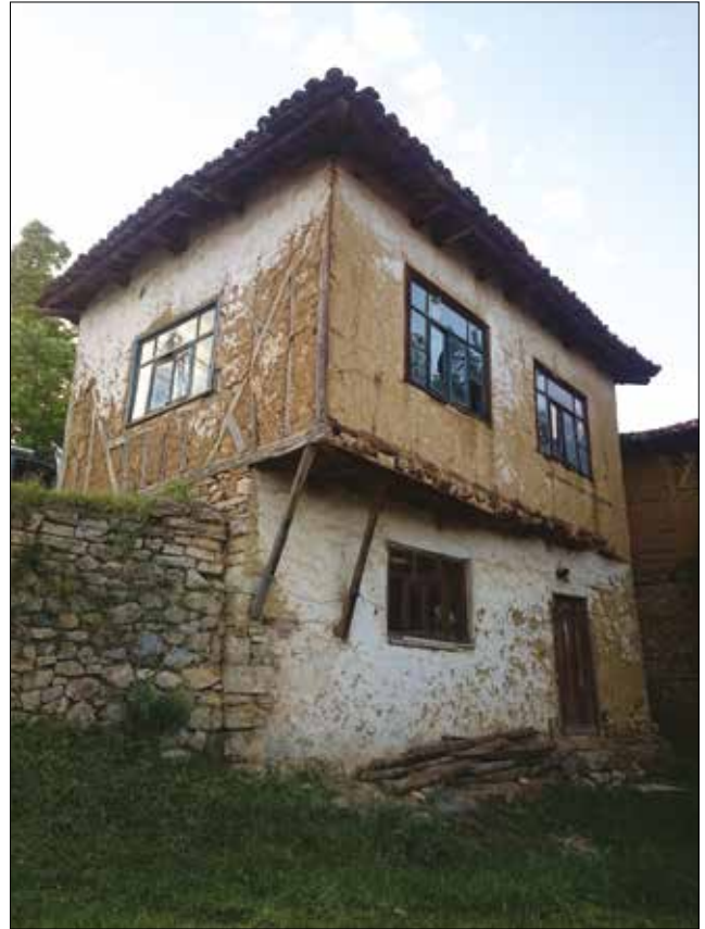
Fotoğraf 31. Açılı çıkmalı yapı örneği (E-49) / Example of a building with an angular projection.
