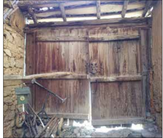
Fotoğraf 34. Dış kapılarda bulunan kilit çeşidi (E-83) (Yıldız, 2017) / A lock sample in exterior doors
