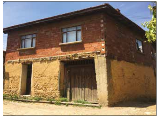
Fotoğraf 49. Yarı yıkılmış durumda yapı (331/9) (Yıldız, 2017) / Half-demolished (horizontally) structure
