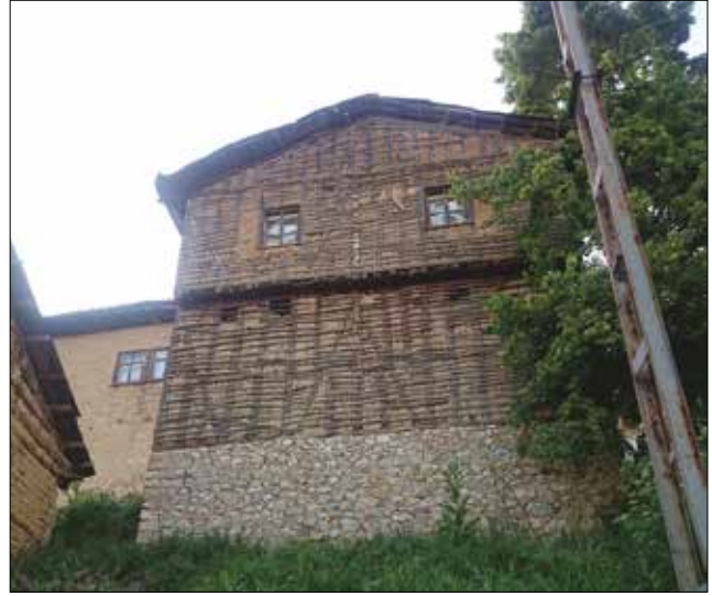
Fotoğraf 37. Ahşap karkaslar arası kerpiç tuğla dolgu ve karkaslar üzerine yapılan bağdadi çıtalı cephe sistemi (E-134) (Yıldız, 2017) / Traditional connotation technique of wooden skeleton with mud brick infill
