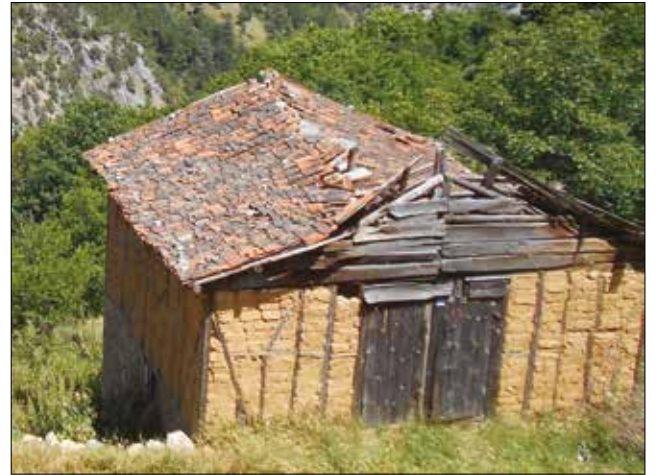
Fotoğraf 46. Kiremitlerde ve çatı sisteminde oluşan bozulmalar (E-19) (Yıldız, 2017) / Deterioration in roof system and tiles.
