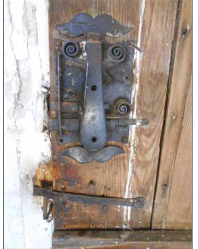
Fotoğraf 45. Metal korozyonunun ahşaba olan etkisi (Yıldız, 2017) / The effect of metal corrosion on wood
