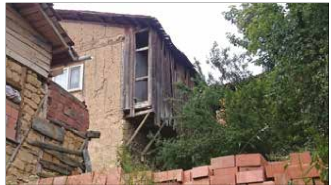
Fotoğraf 27. Hela eki (E-129) (Yıldız, 2017) / Toilet addition
