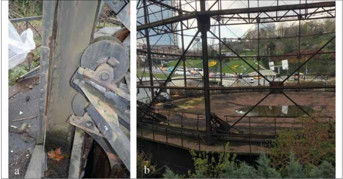
Fotoğraf 6a: Yapıda oluşmuş hasarlar (E. Türkel, Fotoğraf Arşivi, 2017). / Structural damages (E. Türkel, Photograph Archive, 2017).
