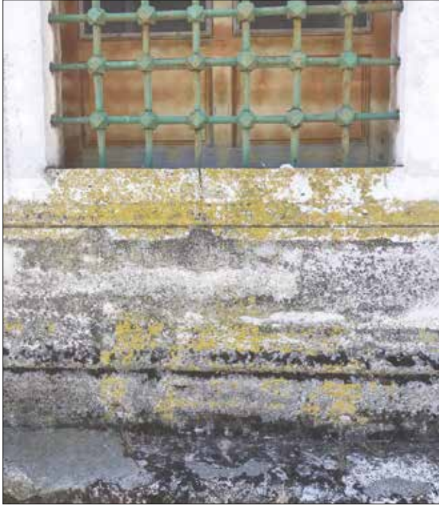
Fotoğraf 14. Zemin suyunun yükselmesi sonucu oluşan bozulmalar / Deteriorations due to rising damp (Cantez, 2018).
