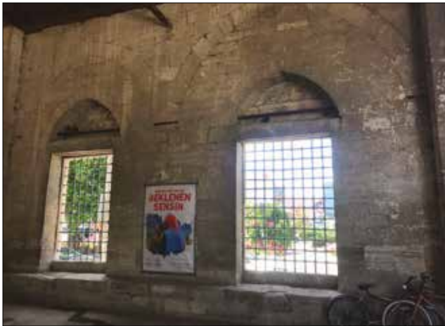
Fotoğraf 16. Son cemaat mahali derz boşalmaları ve çatlaklar / Loss of mortars and cracks on the walls of the last prayer hall (Cantez, 2018).
