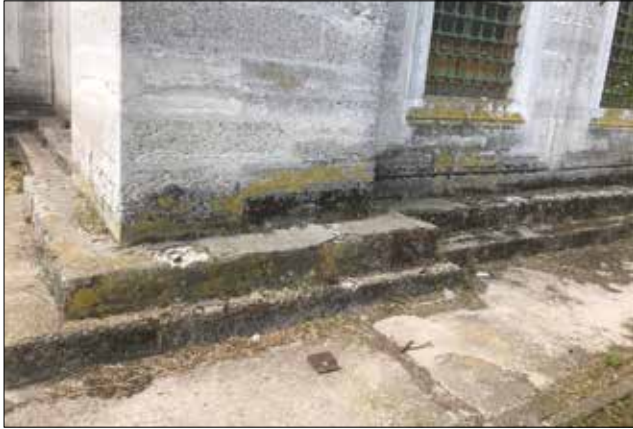
Fotoğraf 15. Zemin suyunun yükselmesi sonucu oluşan bozulmalar / Deteriorations due to rising damp (Cantez, 2018).
