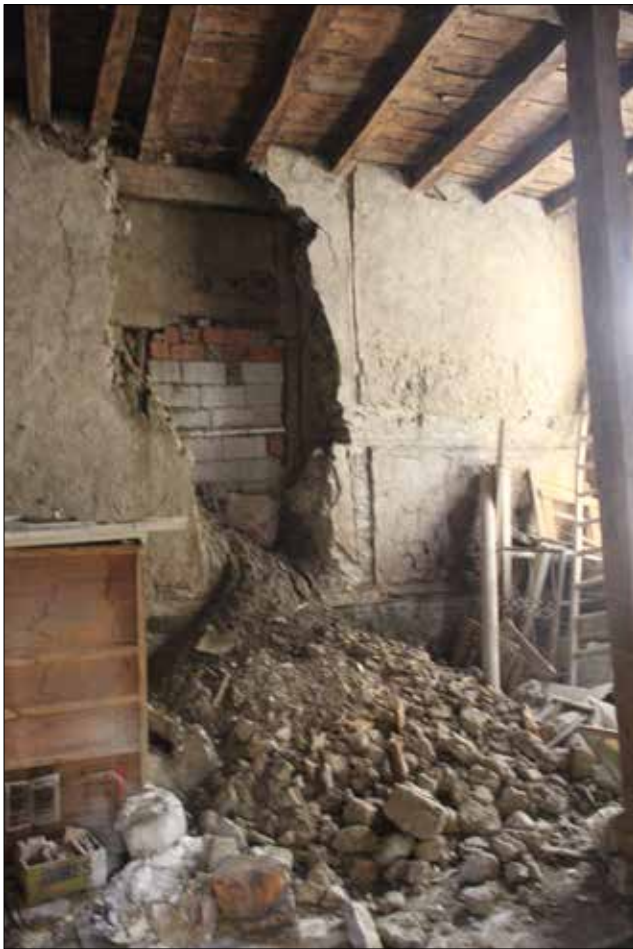
Fotoğraf 25. Yapının Güneydoğu duvarında bulunan ve çatıya kadar çıkan tahribat / The destruction at the southeastern wall which continues up to the roof (A.K. Ercan Arşivi)
