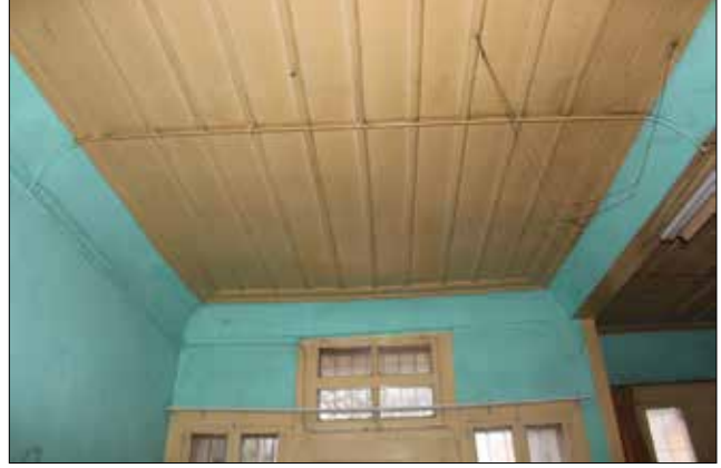
Fotoğraf 23. Duvardan tavana geçişte uygulanan içbükey kavisler / Concave curves applied at the intersection between the wall and the ceiling (A.K. Ercan Arşivi)
