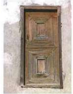
Res. 33. Bir yapının bir kısmı yıkılınca duvar üzerinde kalan özgün oda kapısı.
