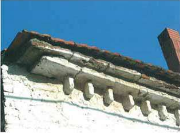
Res. 62. Barbaros Mahallesinde bulunan bir konutun saçığından ayrıntı.
