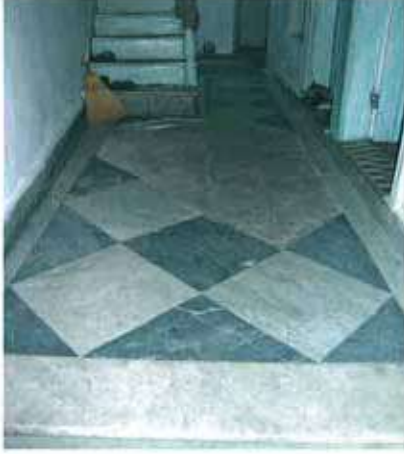
Res. 67. Talatpaşa Mahallesi 455 ada, 27 parselde bulunan konutun (env. no: J18B0032) zemin kat döşeme ayrıntısı.
