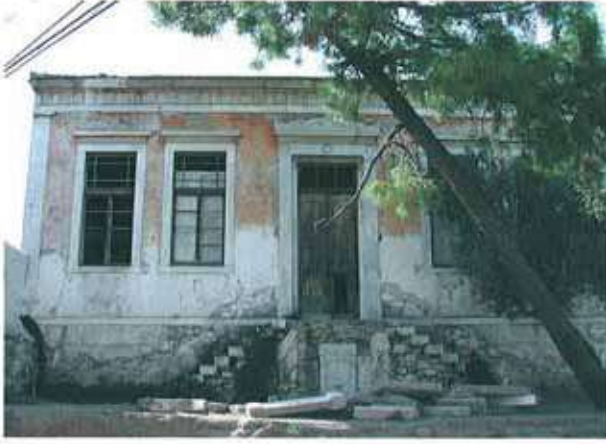
Res. 41. Talatpaşa Mahallesi 456 ada, 55 parselde bulunan eski Rum okulu (env. no: J18B0063). Şek. 27. Okulun (env. no: J18B0063) plan krokisi.
