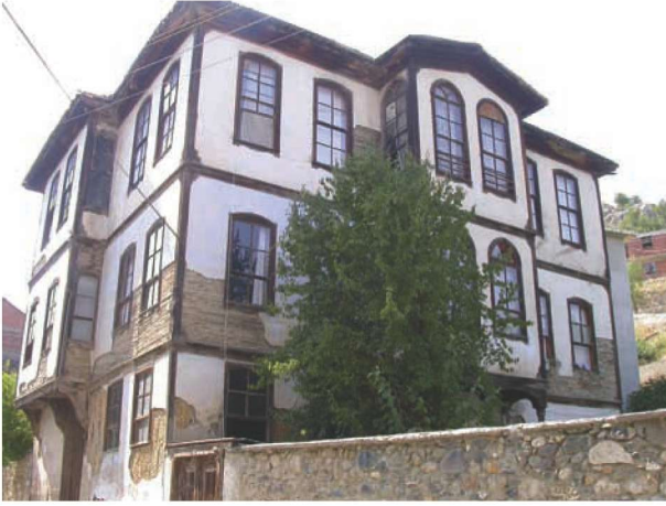
Res. 1. Tarihi Boyabat evlerinden biri ve Kolaz Çayının taşıdığı alüvyonlardan derlenen kayaların kullanıldığı bahçe duvarı (gözl. no: F33.JB3.1).
