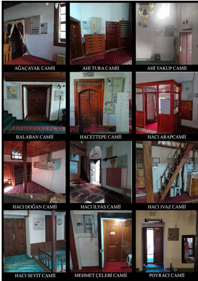
Şekil 11. Çıkışa Yakın Elektrik Panosu (Electrical Panel Near Exit)
