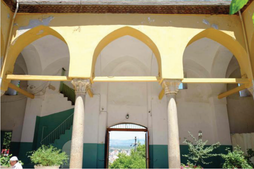
Fotoğraf 3- Ulu Cami. Onarım öncesi avlunun kuzey kanadı.
