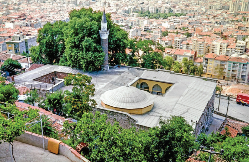
Fotoğraf 28- Onarım öncesi yapının betonarme örtüsü.
