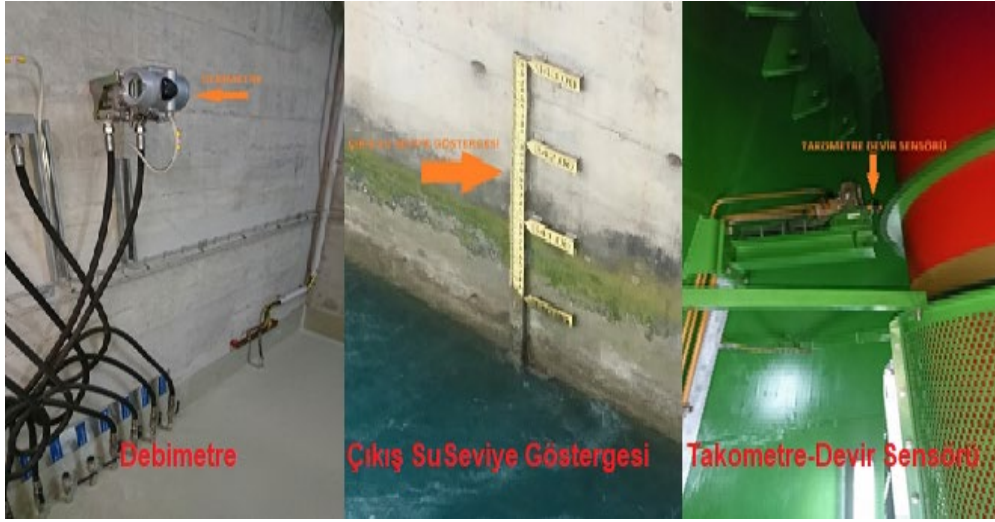
Şekil 2. Debimetre, Çıkış suyu seviye göstergesi, Takometre –Devir sensör
