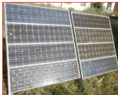
Fig. 8. UDTS50 photovoltaic panels
