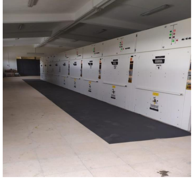
Şekil 8. Elektriğe manevra işleminin yapıldığı şalt binası
