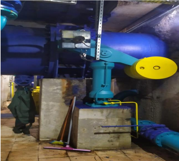
Şekil 4. Santral binasında dallanan cebri borulardan birinin türbine gidişi
