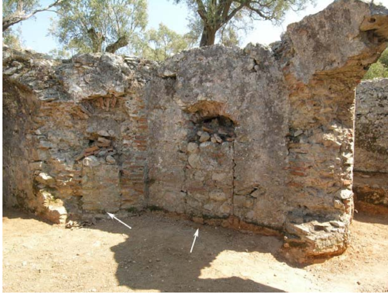
Res.22- Yelli Hamam. Sıcaklık orta mekanının güney kenarı üzerindeki kapatılmış iki giriş.
