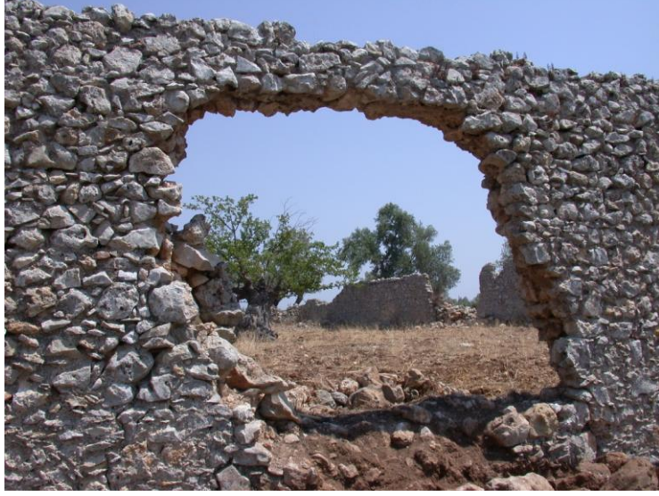
Res.32- Emir Avlusu. Büyük avlu batı duvarı üzerindeki gedik (onarım öncesi)
