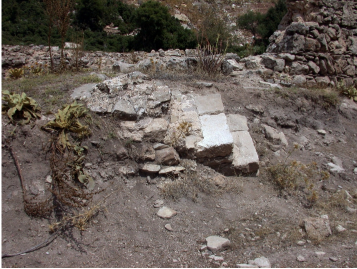
Res.25- Tahtalı Beli Hanı. Güneydeki merdiven kalıntısı. Phot.25- Le Khan de Tahtalı Beli. Marches d'escalier à côté du mur sud.
