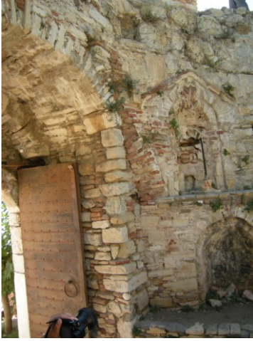
Resim 20: Ana giriş kapısının gerisindeki tamir izleri.
